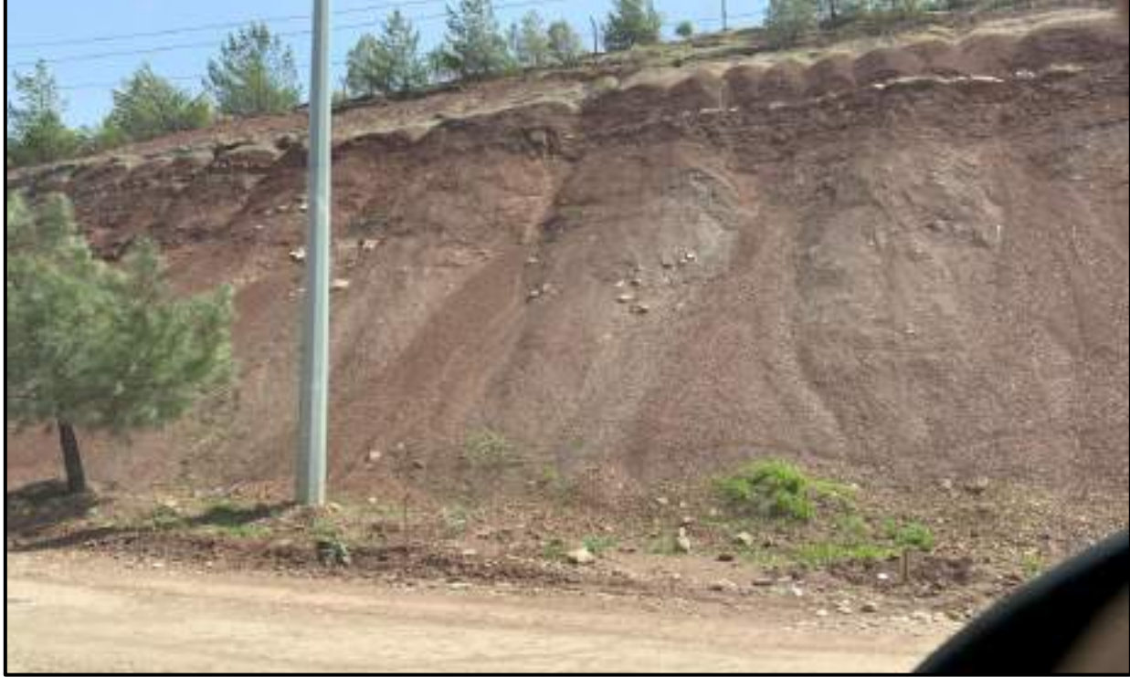
صورة (42) زحف التربة شمال غرب منطقة الدراسة
