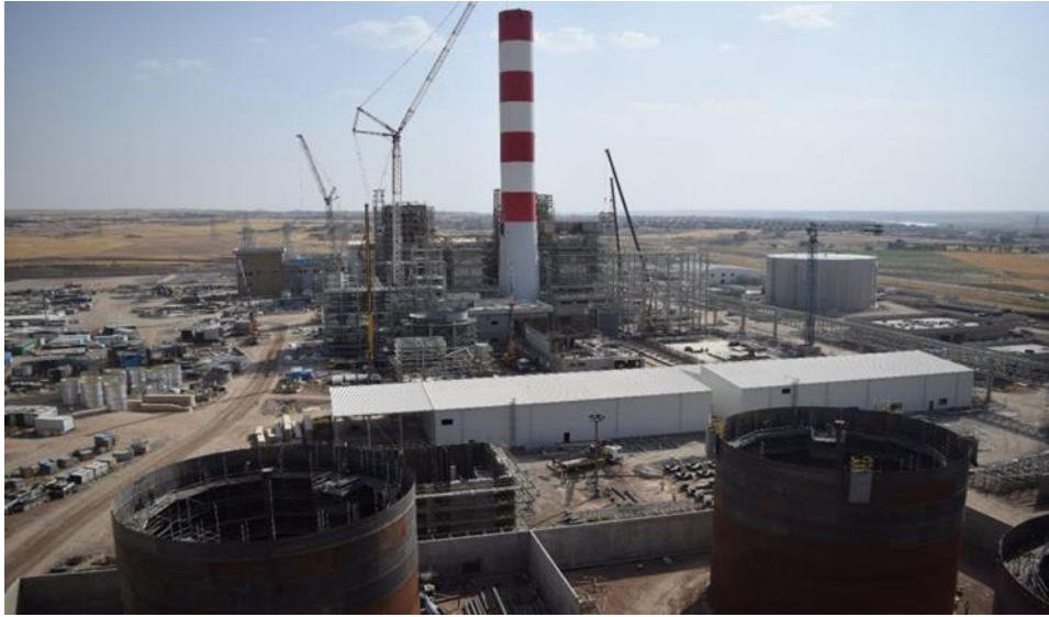
Рисунок 1.14. электростанция ХАБАТ мощностью 2x150 МВт/блоки 1 и 2
